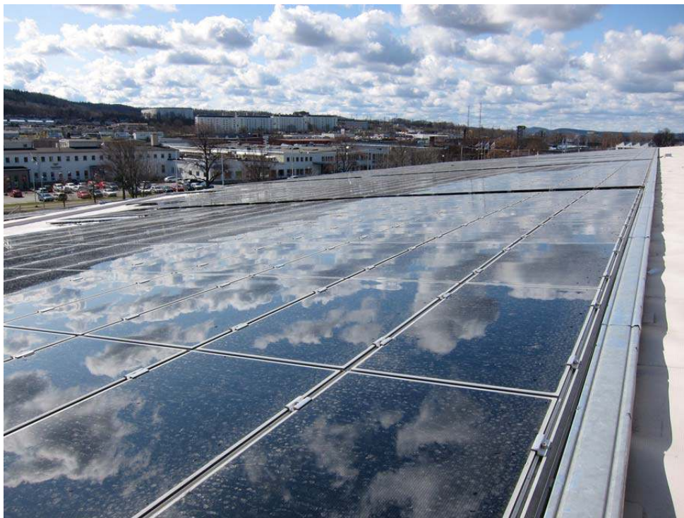
Figure 4: Ett solcellssystem bestående av tunnsolceller som installerades på taket till badanläggningen Rosenlundsbadet i Jönköping (Foto: Glacell)
