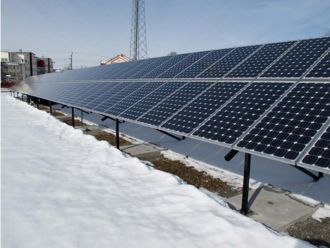
Figur 3: Sveriges första solcellssystem där man tillämpar inmatningstariff och också det första nätanslutna centraliserade solcellssystem. Systemet finns i Sala.
