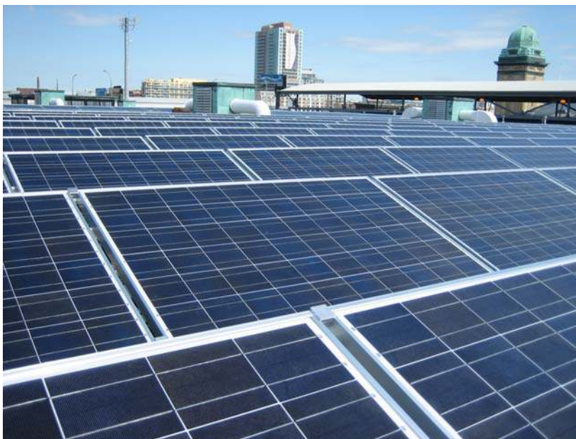
Figure 1 : Système PV de 1100 kW installé sur le toit à l'Exhibition Place, Toronto (Ontario) Canada. (Photo : Exhibition Place)
