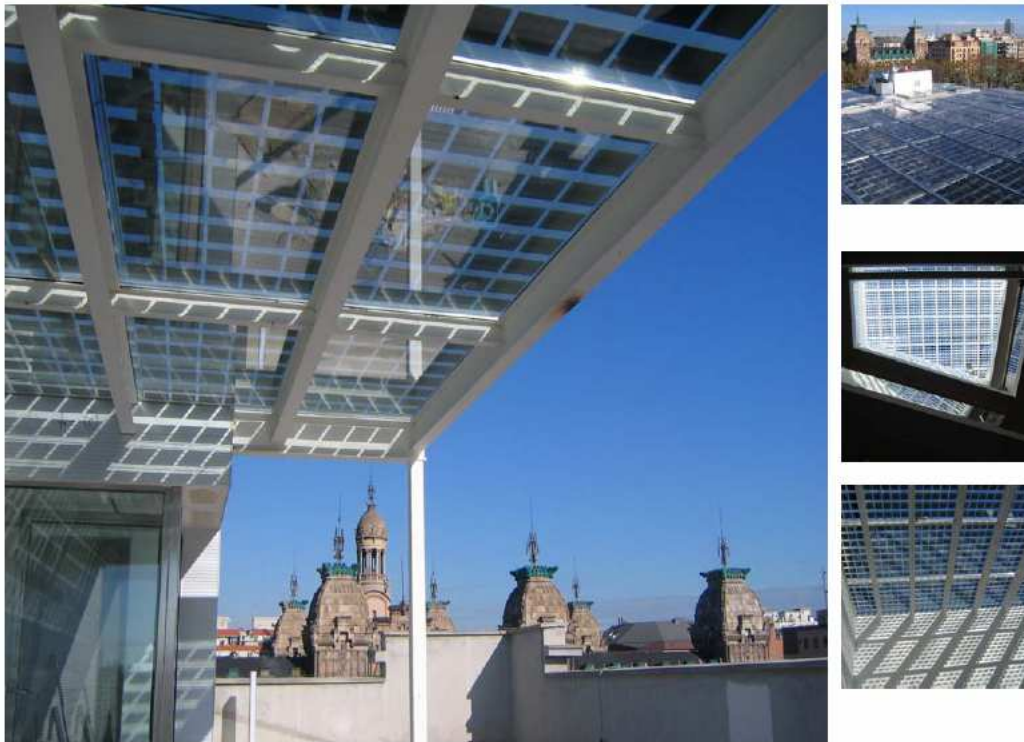
Figure 13 Skylight in the Síndic of Greuges, Passeig Lluís Companys, Barcelona (5,4 KWp)
