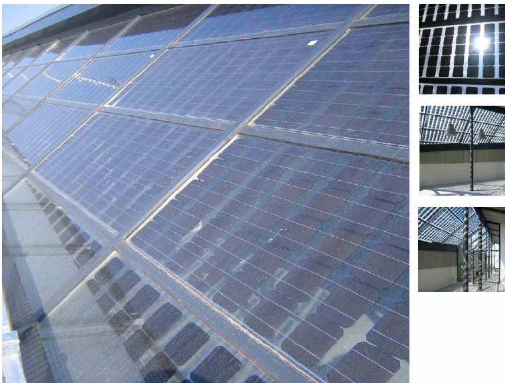
Figure 16 Façade of the a creche 2008, Barri Serra de Sanferm Vic (Barcelona) 4,26 KWp
