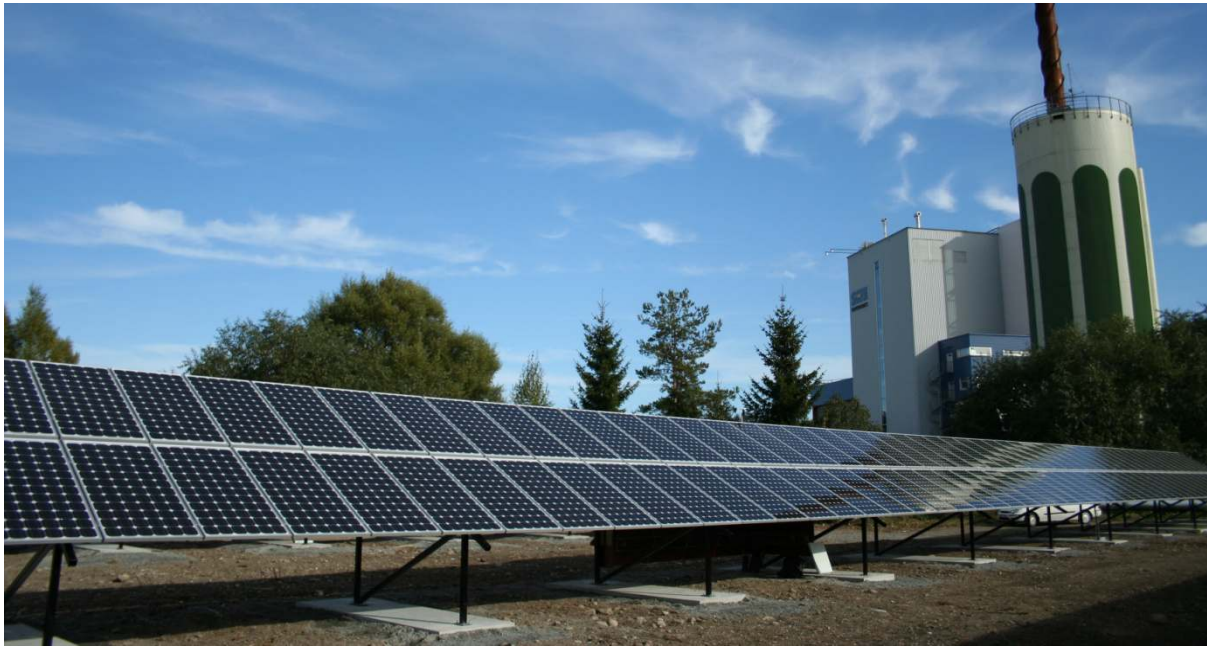
Figur 2: Det andra av två system som omfattas av den lokala inmatningstariffen i Sala-Heby. Systemet har en maxeffekt på 78 kW. (foto: Hans Nyhlén, Solel i Sala&Heby ekonomiska förening)
