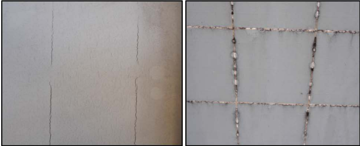
그림 10: PA 균열. PA 백시트를 사용한 태양광모듈의 세로와 정사각형 균열 [7].
